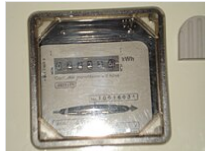
Contador doméstico de energía eléctrica.
